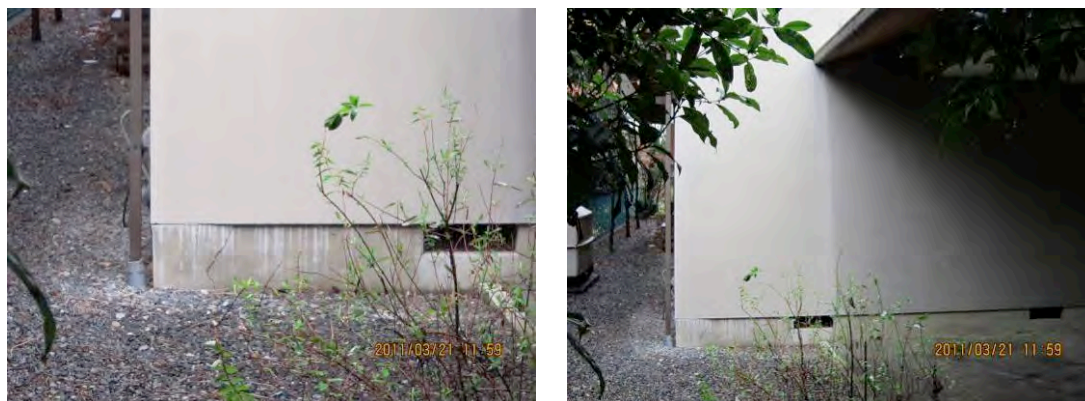
図 K-net 隣接家屋のひび割れ，基礎の亀裂
