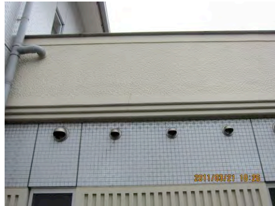
図 C:壁上部に斜めひび割れ
