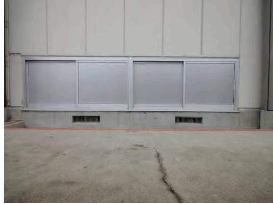
図 B: サッシ下のひび割れ
