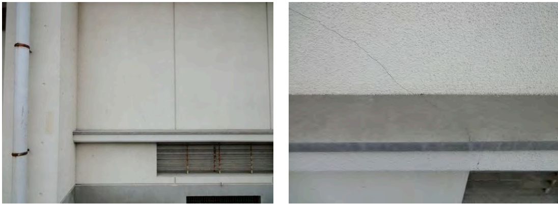
図 A: 体育館耐力壁の斜めひび割れ
