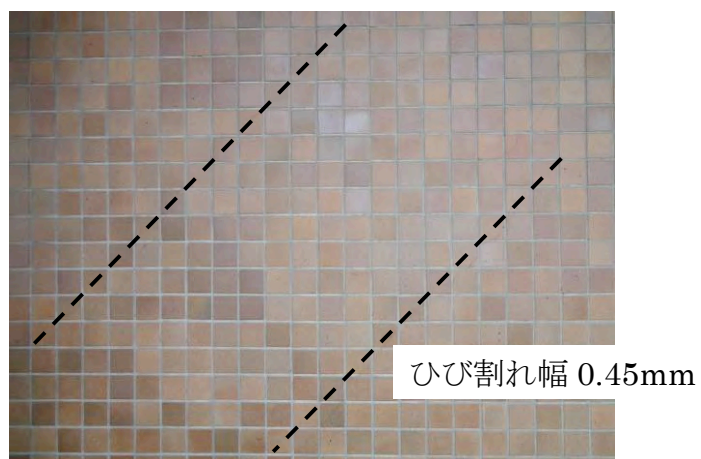
図 A:複数の斜めひび割れ
