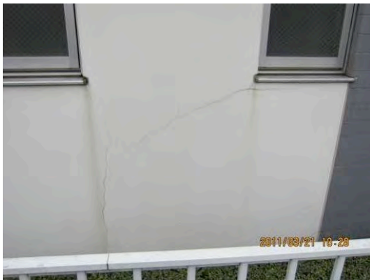
図 B:開口部周辺の斜めひび割れ
