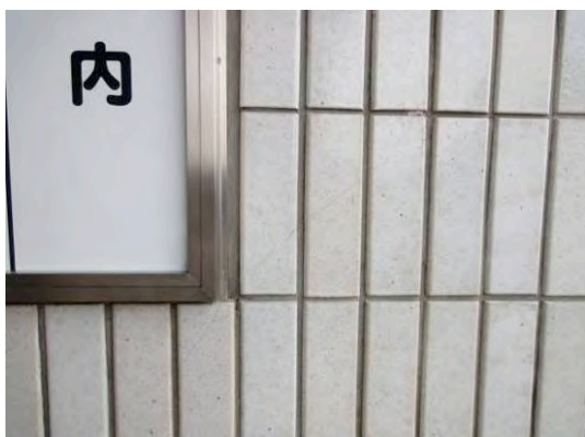
図 B:タイルの斜めひび割れ
