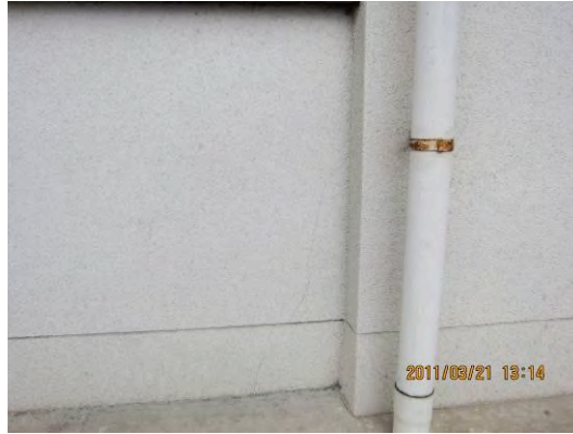
図 D:腰壁の亀裂
