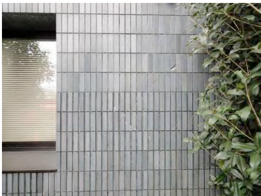
図 A:雑壁の斜めひび割れ
