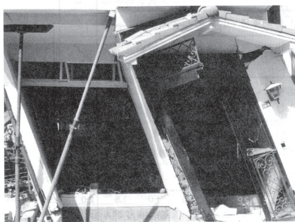
写真2. 狭小間口の木造住宅の被害（芦屋市）
